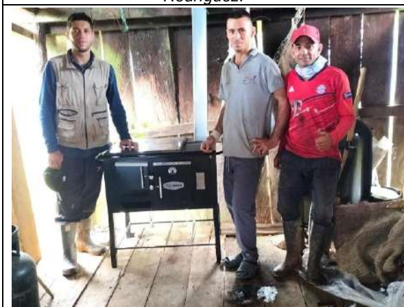
Foto. Verificación instalación estufa-Cersain Muñoz-Vda Estrella
