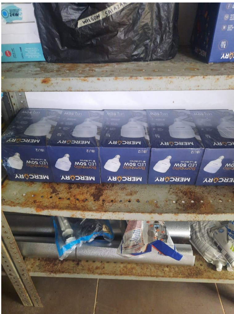
Imagen 4. Almacén – Estantería en mal estado
